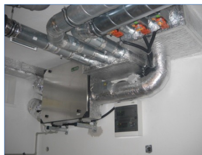
Strojovňa v garáži
