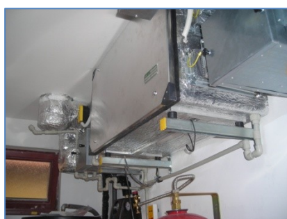
Strojovňa v technickej miestnosti
